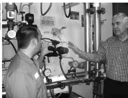
Une visite guidée à l'HND: l'appareil est une chaudière à huile lourde. Yannick Sylvain, mécanicien de machines fixes, donne des explications au visiteur Denis Labrecque, agent administratif.
